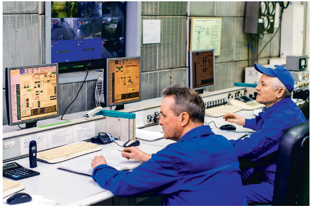
Пульт автоматизированного управления газотурбинными двигателями при испытаниях. ПАО «ТМ»
